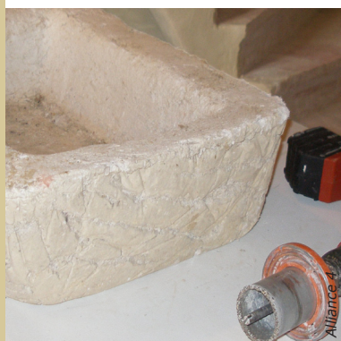
Le support est recouvert d'un corps d'enduit granuleux afin d'assurer une bonne accroche.
