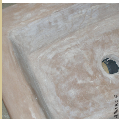
Après un temps de carbonatation, l'enduit est nourri avec du savon noir dilué puis longuement ferré pour le faire pénétrer.
